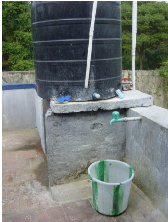
Abbildung 5: Das Wasser muss von einem Tank am Dach geholt werden
