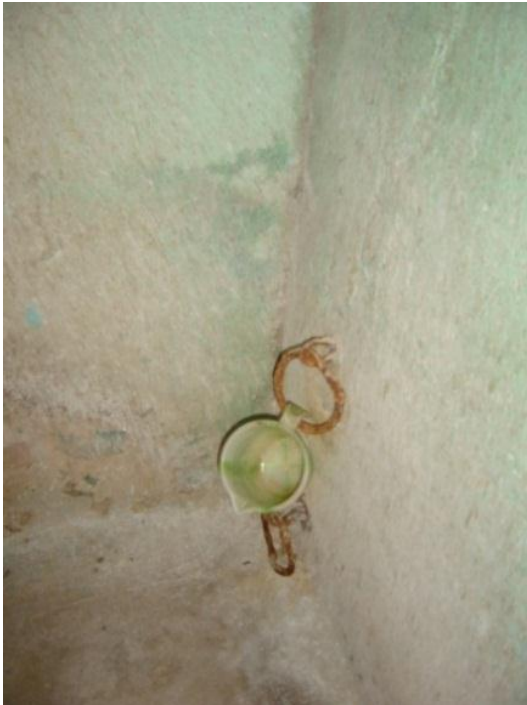
Abbildung 4: Es gibt weder Fließwasser noch eine Tür in diesem Badezimmer
